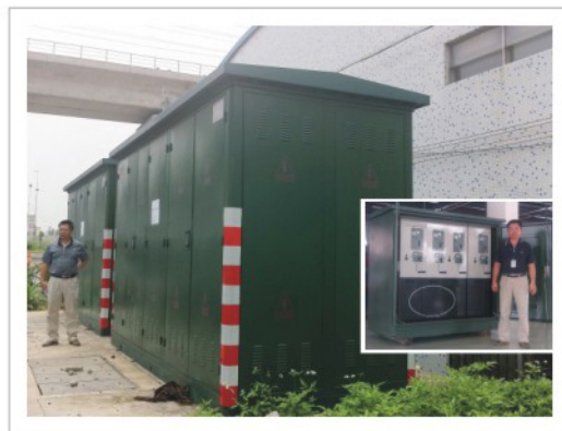
在户外开关站改造上的应用
