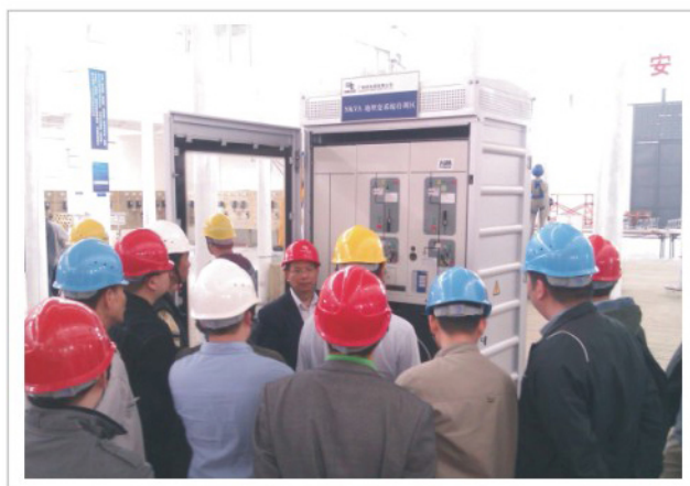
在景观式箱式变电站上的应用
